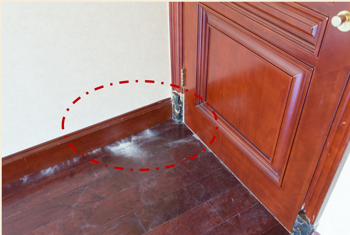
2 踢脚线与地板间隙不统一、基层浮灰未扫净
